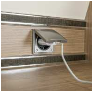
Contactdozen Optimaal geplaatst, gemakkelijk te bereiken
